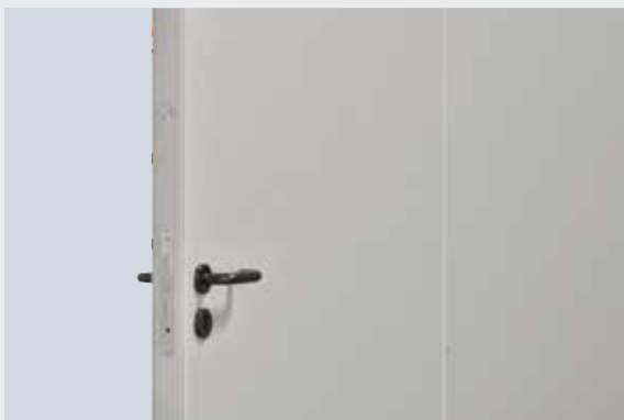
Not-fjeder-elementforbindelse i plant niveau, som er klæbet over hele fladen, portbladets tykkelse 72 mm
